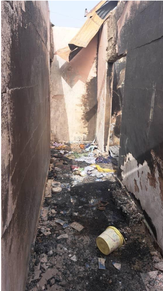
Abbildung 22 - Brandschaden auf der Hofseite
